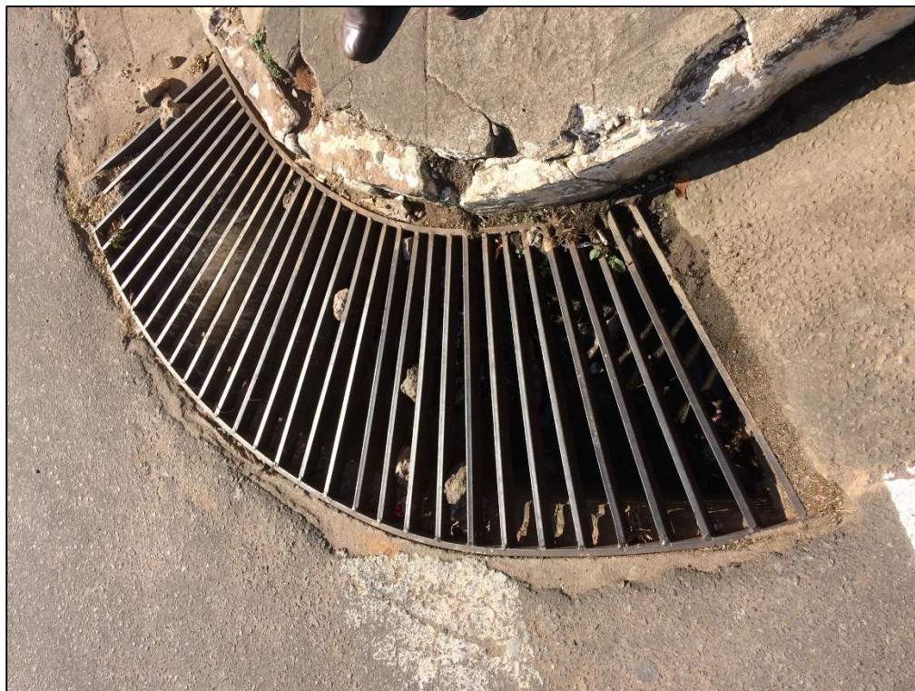
Figura 4.23 – Localização inadequada de boca de lobo Fonte: Equipe UNIS, 2017
