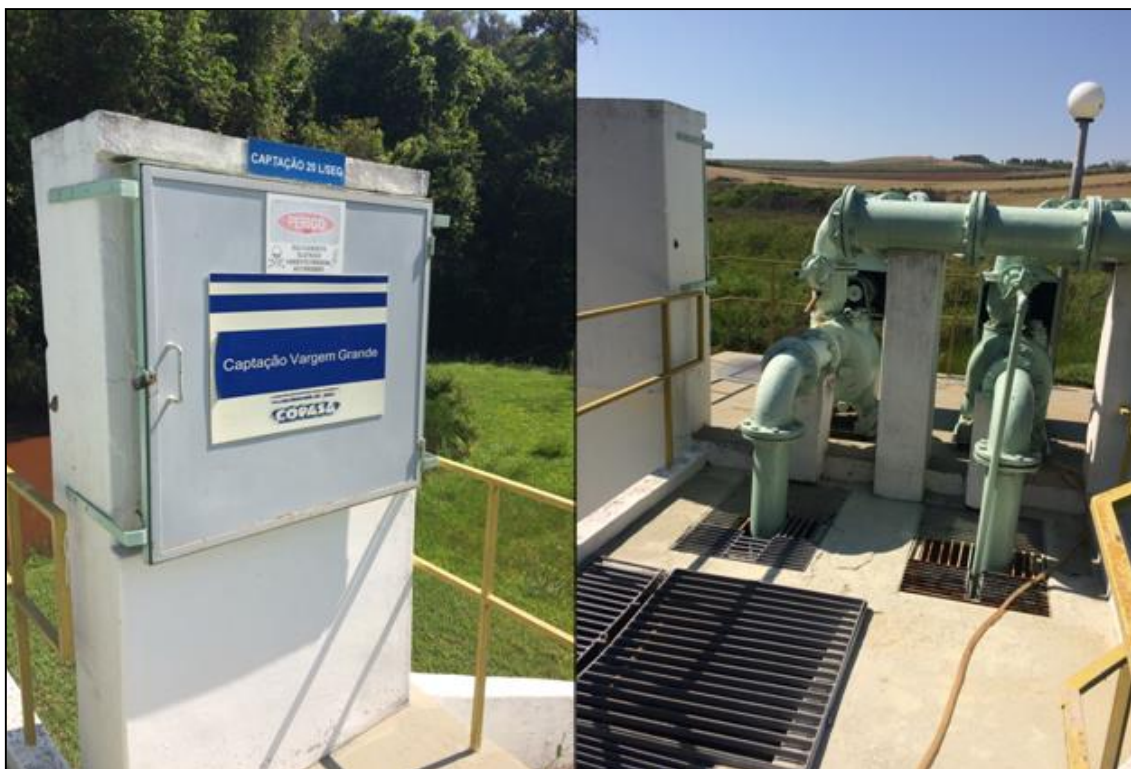
Figura 4.2 - Sistema elevatório de água bruta (EAB) Fonte: Equipe UNIS, 2017
