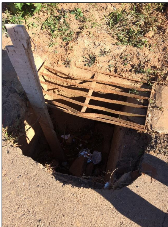
Figura 4.22 – Boca de lobo obstruída Fonte: Equipe UNIS, 2017
