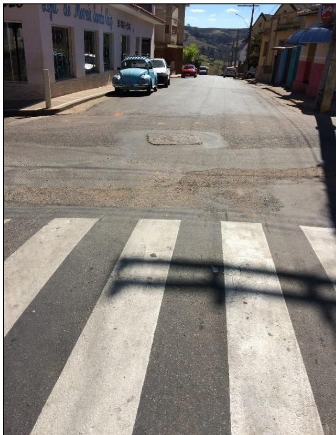
Figura 4.12 – Poço de visita coberto por pavimentação asfáltica Fonte: Equipe UNIS, 2017
