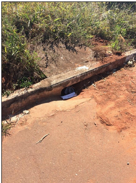
Figura 4.20 – Boca de lobo obstruída Fonte: Equipe UNIS, 2017
