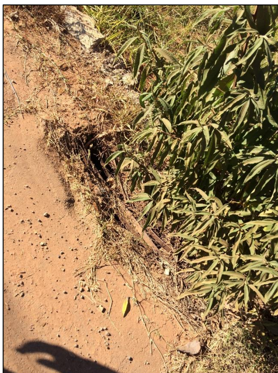
Figura 4.21 – Boca de lobo obstruída Fonte: Equipe UNIS, 2017
