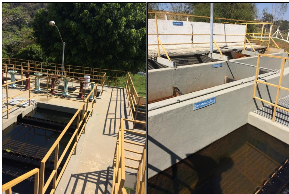
Figura 4.3 - Estação de tratamento de água Fonte: Equipe UNIS, 2017
