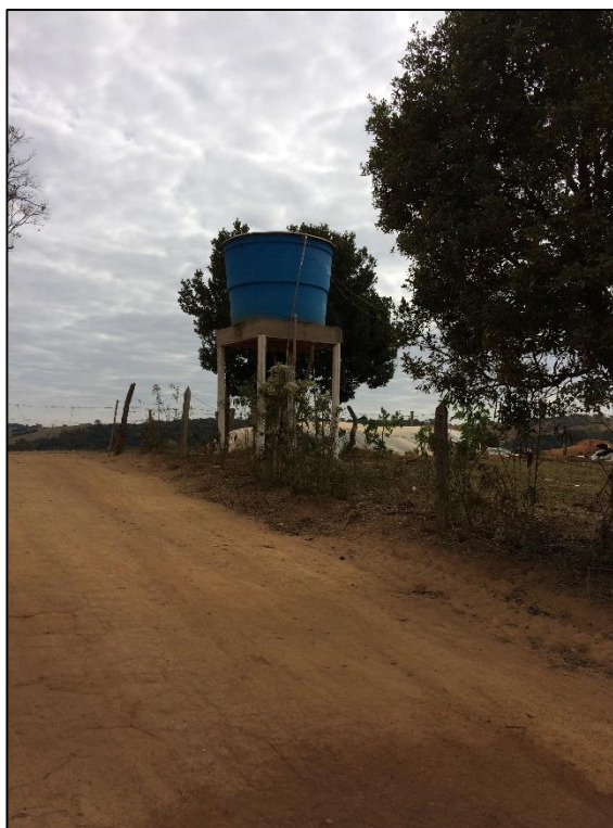
Figura 4.8 –Reservatório de distribuição Fonte: Equipe UNIS, 2017
