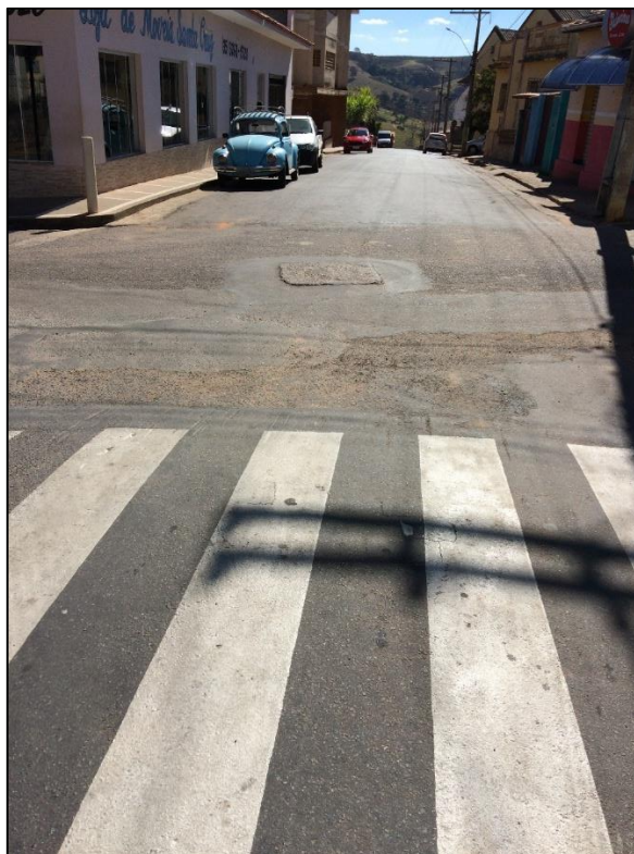
Figura 4.15 – Ausência de sarjetão no cruzamento de vias Fonte: Equipe UNIS, 2017
