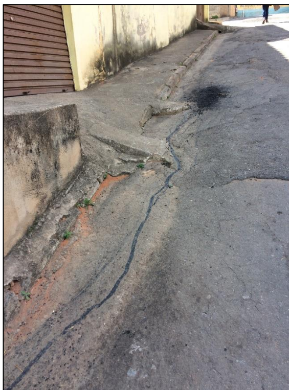
Figura 4.19 – Condução das águas pluviais para a calha viária Fonte: Equipe UNIS, 2017
