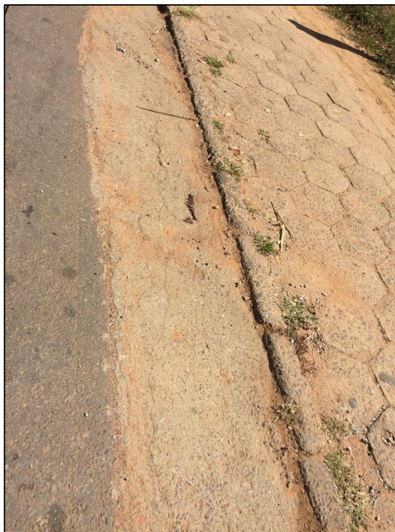
Figura 4.17 – Redução da altura do meio fio pelo recapeamento de via. Fonte: Equipe do UNIS, 2017
