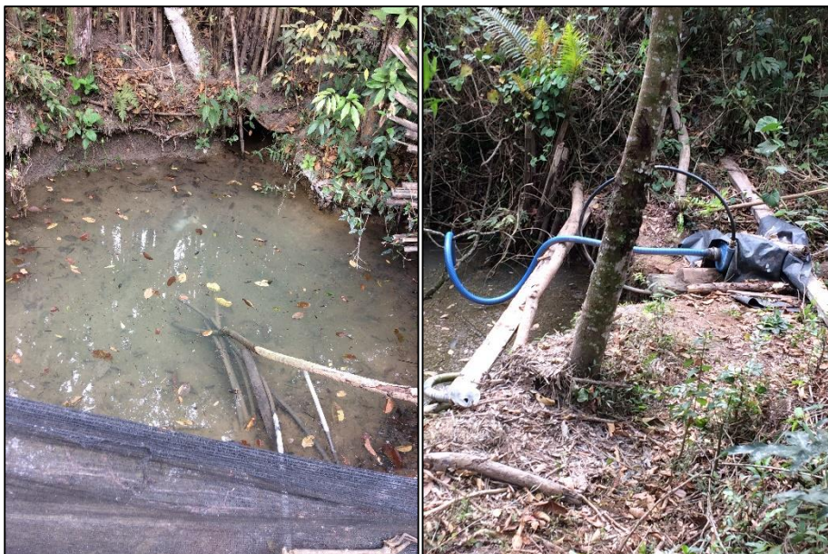
Figura 4.6 – Ponto de captação da água (surgência) – Comunidade Óleos Fonte: Equipe UNIS, 2017
