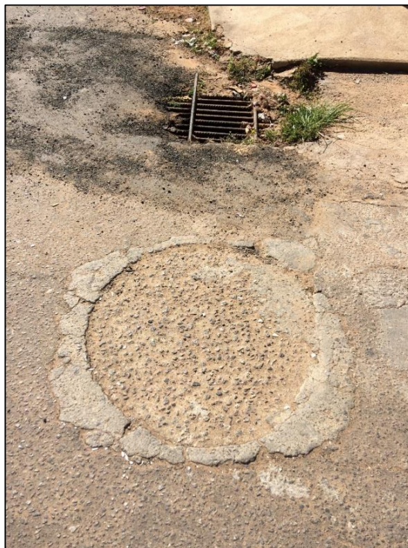
Figura 4.11 – Poço de visita coberto por pavimentação asfáltica
